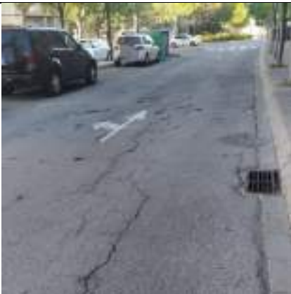
PASEO JOAN MIRO, ASFALTO MUY DAÑADO
